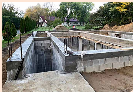
Een beeld van de schuilkelder bij het bejaardentehuis in aanbouw. De bouw van de kelder is inmiddels voltooid.
