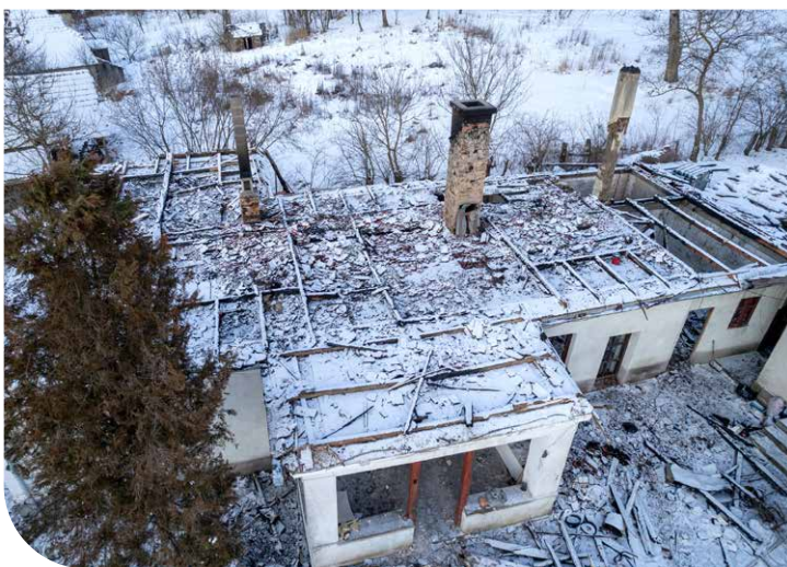
Het dak na de brand
